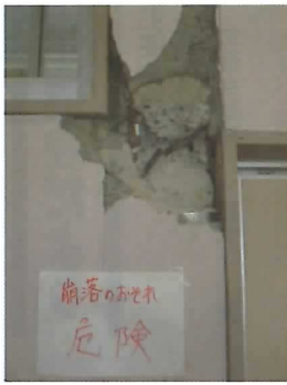
D棟2Fにて コンクリートの壁が崩れ鉄筋も切れている
